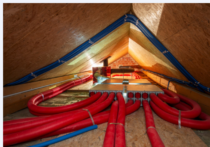
Gli impianti tecnici per il ricambio di aria trovano posto anche sotto le tegole.
